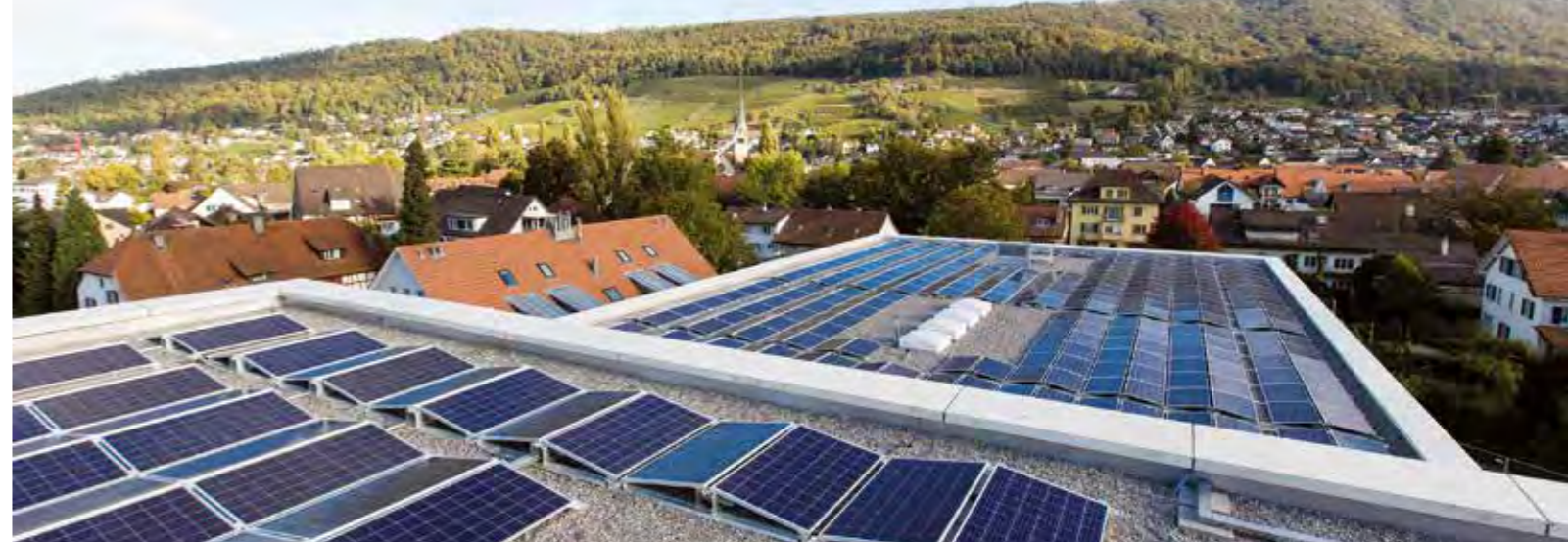
Die Solaranlage auf dem Schulhaus Zehntenhof.
